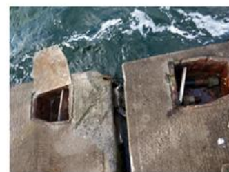
Conexiones rotas en las zonas de acoplamiento en los módulos
